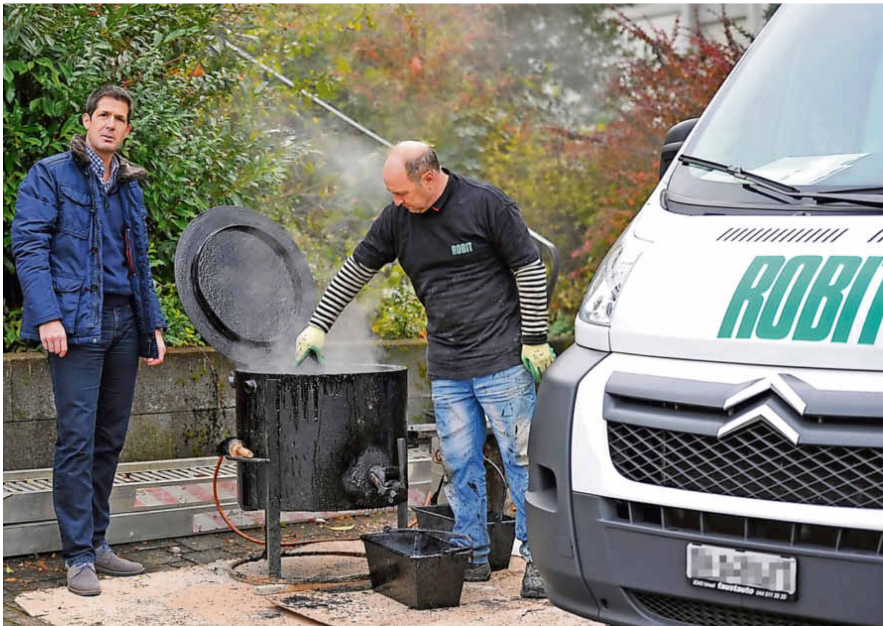
Kein Marronigrill, sondern ein Teerkocher: Robit-Firmenchef Bruno Meier (links) und einer seiner Mitarbeiter erhitzen Bitumen für den Anstrich auf dem Boden. Bild: Christoph Bantli
